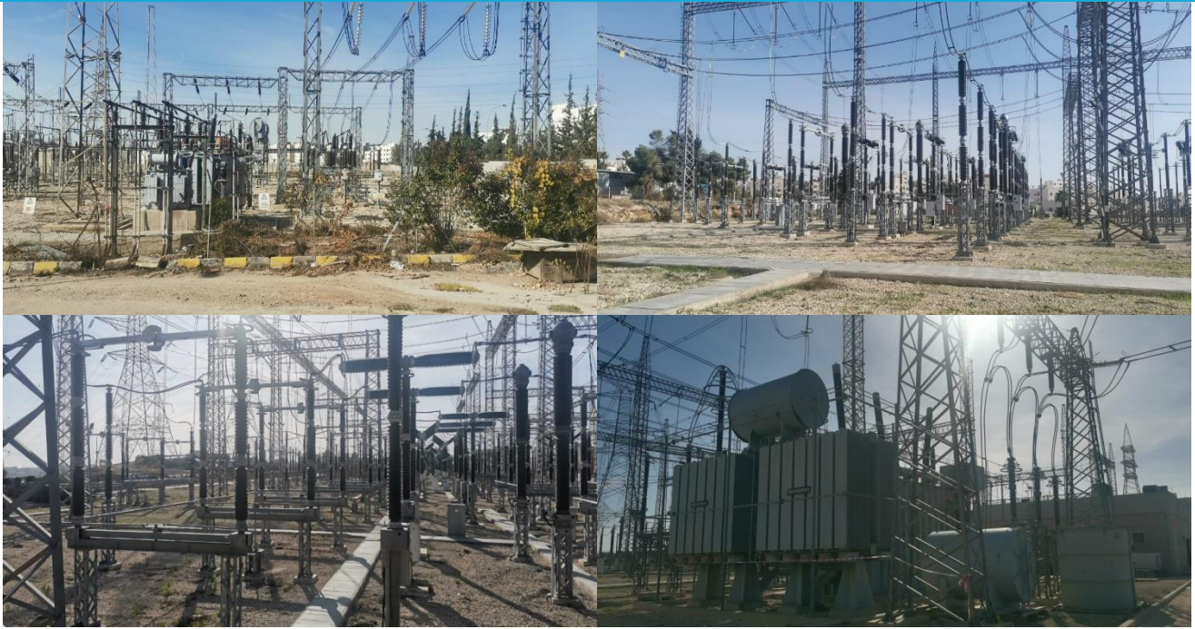
الشكل 4: صورة نموذجية لمحطة التحويل
